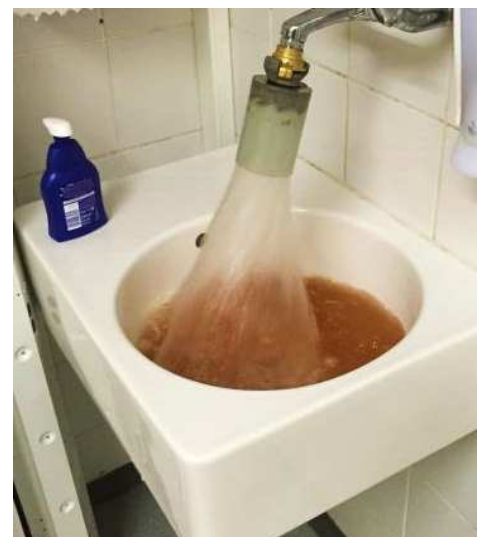
Abbildung 2: Ausspeisung über Waschbecken mit Zyklonabscheider (Archivbild)
