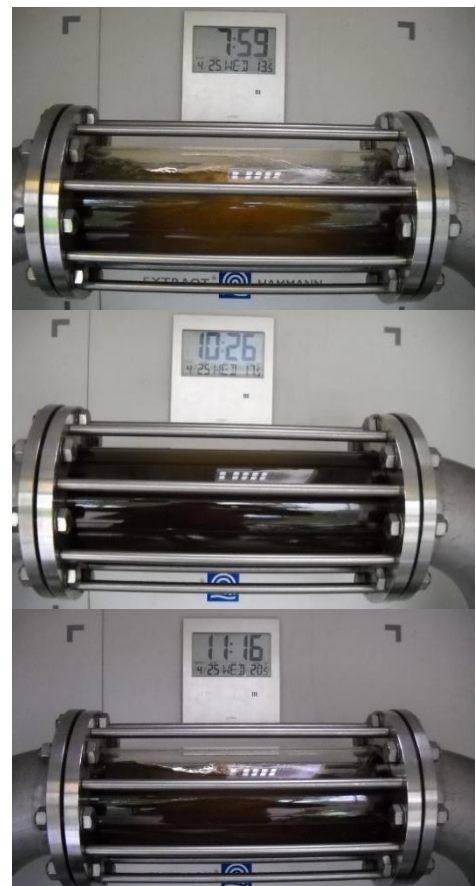
Abbildung 3: Trübung in Schauglas während der Wasser-Saug-Spülung
