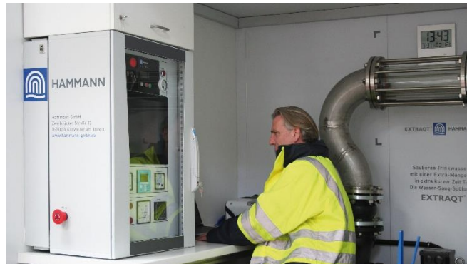
Abbildung 1: Techniker im Einsatz
