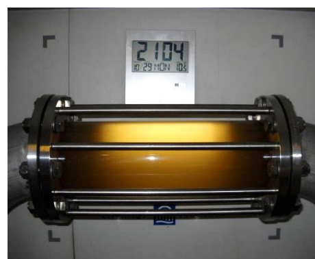
Abbildung 4: Verfolgen des Trübungsverlaufes im Schauglas
