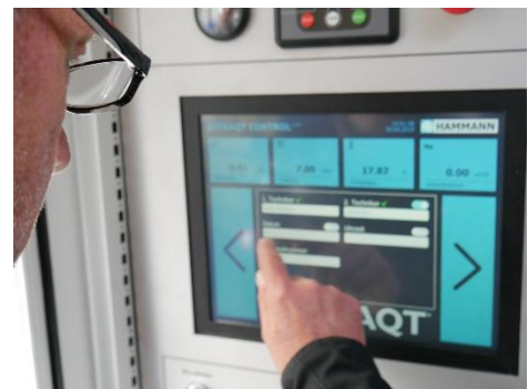
Abbildung 3: gezielte Anpassung der Pumpenleistung
