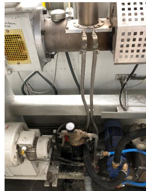
Abbildung 5: Einzugszonenkühlung und Dichtwasser Entgasungspumpe
