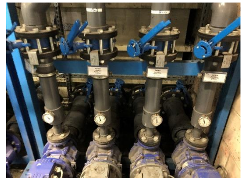
Abbildung 2: Vorlauf des Kühlwassersystem
