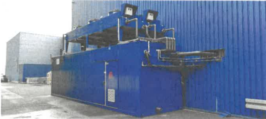
So spart man Platz und minimiert die Inbetriebnahmezeit: Die neue Kälteanlage im Hörmann-Werk Werne ist in einem Container untergebracht.
