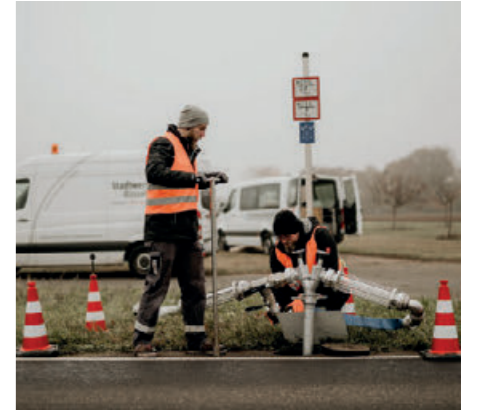
Bild 5 Techniker und Equipment an der Ausspeisestelle Quelle: Hammann GmbH
